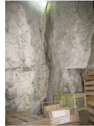
Photo 10: Ind 030, fractures, blocs instables.
