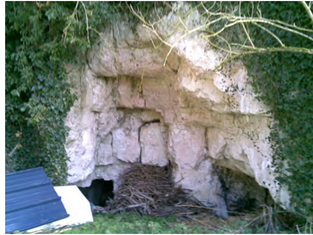
Photo 8: Ind. 015, entrée de la carrière avec coteau fortement fracturé
