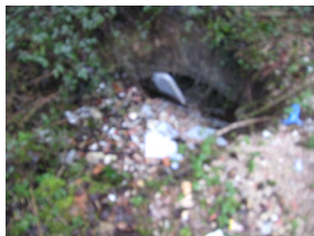
Photo 2: Ind. 076, fontis remblayé par des dépôts divers
